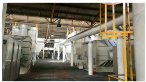
▲ 廢氣處理設備
